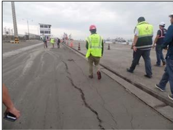
Asentamiento de la vía hacia Muelles Marginales.
