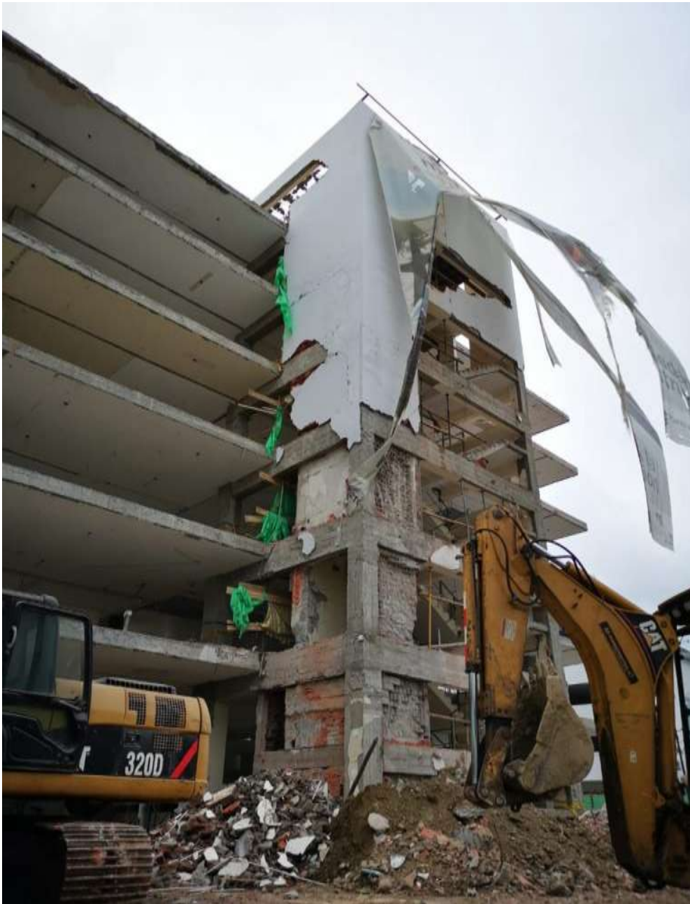
Ilustración 4: Edificio original, post-terremoto.
