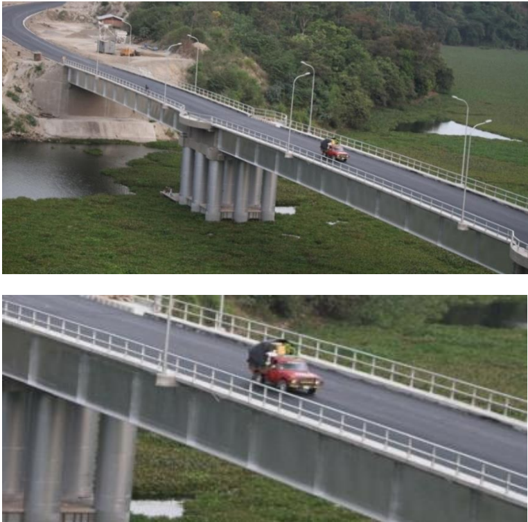
Ilustración 13 Pérdida de gálibo por la presencia de vigas metálicas descolgadas en el tablero
