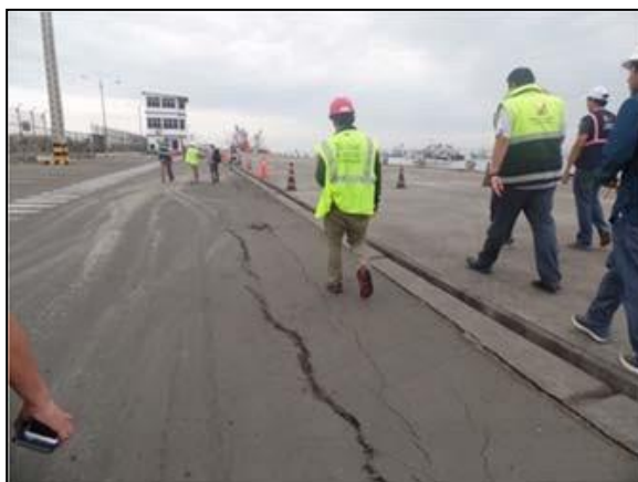
Asentamiento de la vía hacia Muelles Marginales.
