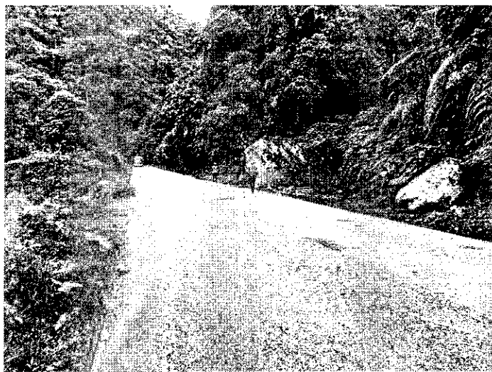
Deficiencia de Drenaje, falta de mantenimiento
