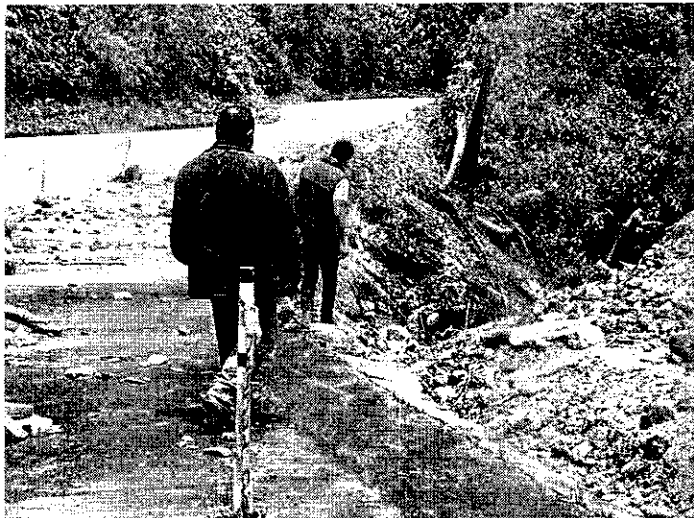
Sito Crítico, parte de la estructura de via colapsada
