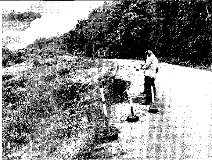
Sito Critico, parte de la estructura de via colapsada
