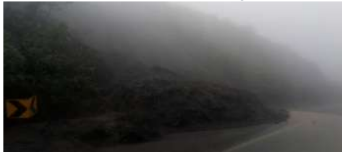
Ilustración 18 Deslizamiento de material sobre la vía en una longitud de 30m; Absc. 93+500.
