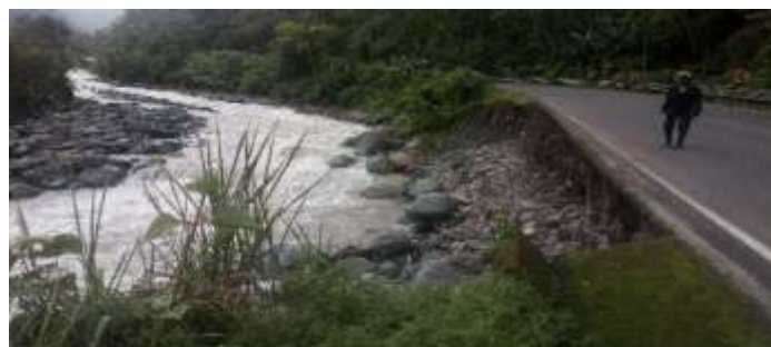
Ilustración 27 Afectación sobre la estructura vial. Km. 112+300.
