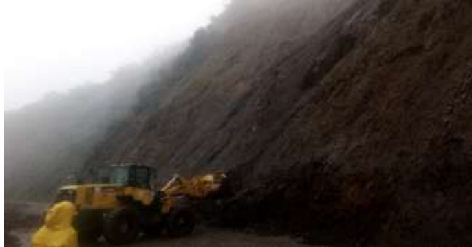
Ilustración 17 deslizamiento sobre una longitud de 80m. Absc. 92+300
