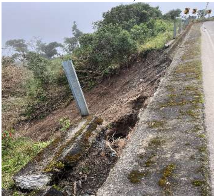
Ilustración 11 Micro deslizamiento del suelo de relleno afecta a la mesa de la vía. Absc. 79+500.
