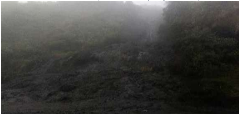
Ilustración 8 Zona de deslizamiento de altura aproximada 20m y longitud de limpieza 15 a 20m. Absc. 74+700
