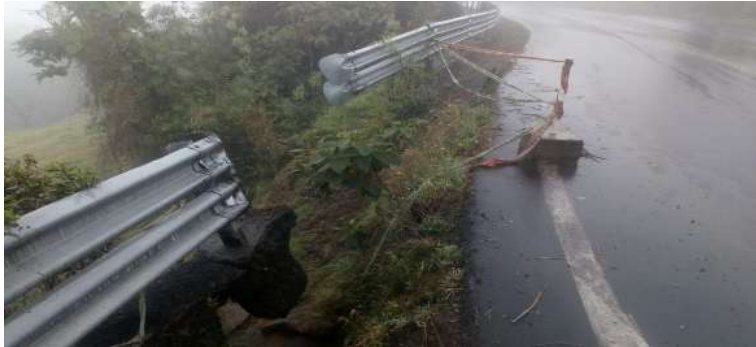
Ilustración 13 desprendimiento lateral de cuneta y guardavía; Absc. 83+700.
