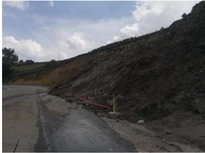
Ilustración 1 Fotografía de deslizamiento talud superior derecho, suelo saturado.
