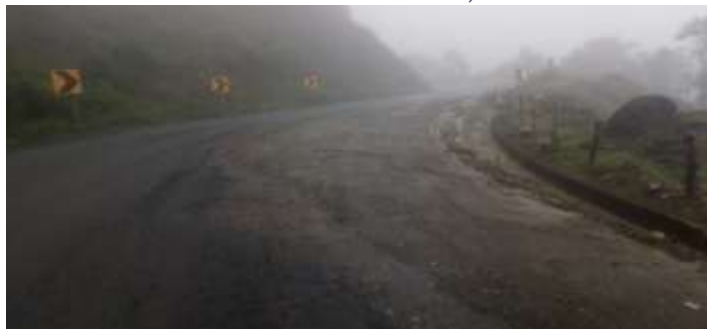
Ilustración 14 Asentamiento de la vía, Absc. 87+500
