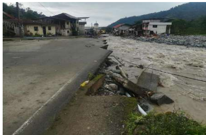
Ilustración 2 Fotografía de Pérdida total de la vía y destrucción de viviendas en el Recinto El Palmar.
