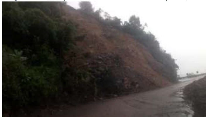
Ilustración 16 Afectación vial por deslizamiento de talud superior; Absc. 91+900.
