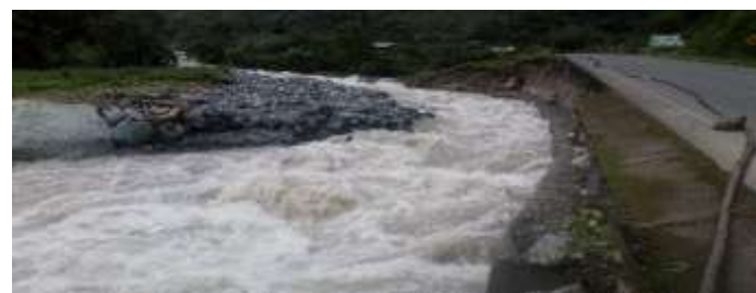
Ilustración 28 Afectación sobre la estructura vial. Km. 112+500.
