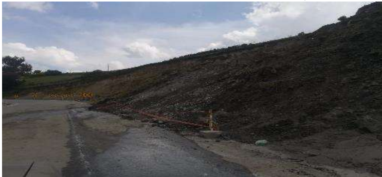
Ilustración 7 Deslizamiento de material en el talud derecho, Absc. 64+700
