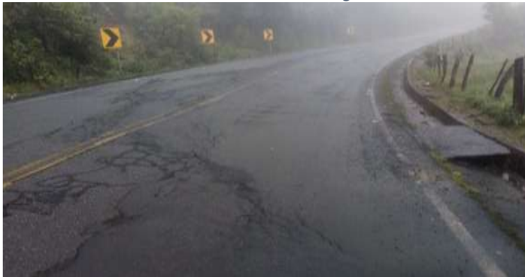
Ilustración 10 Asentamiento de la vía con una longitud de 60m. Absc. 77+100.
