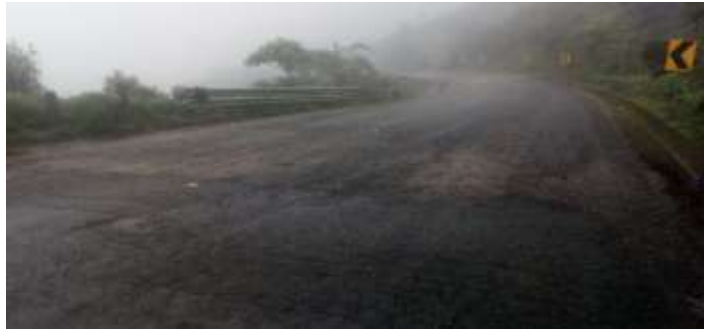
Ilustración 15 Asentamiento vial de 120 m de longitud; Absc. 89+500.
