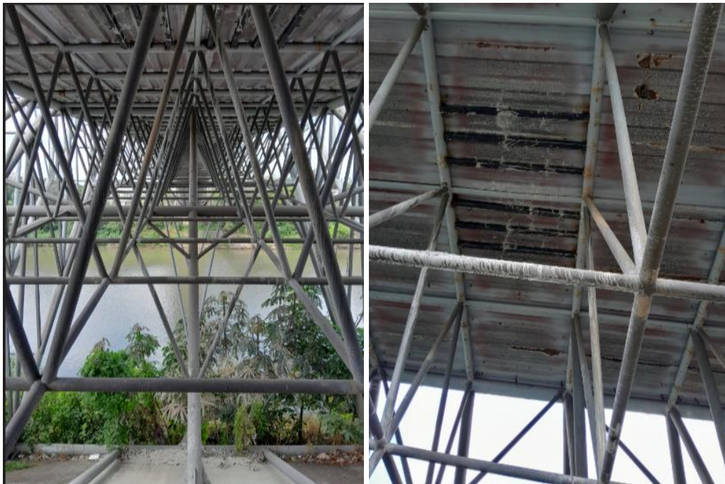
Foto 5 y 6. Steel Panel en mal estado.
