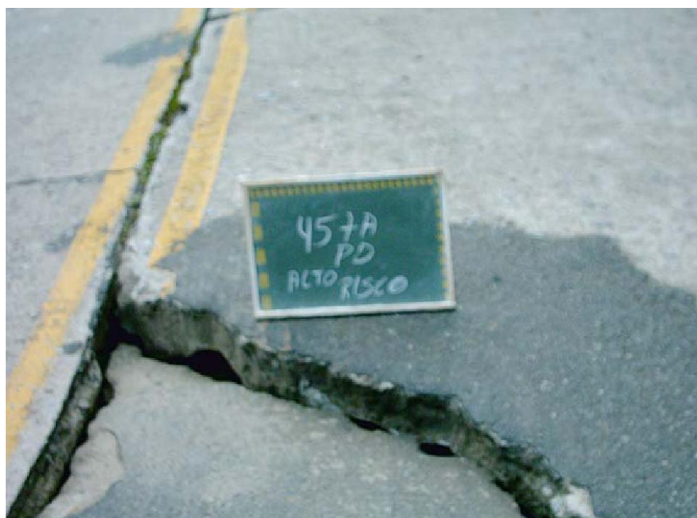
Fotografía 14: Rotura de canto
