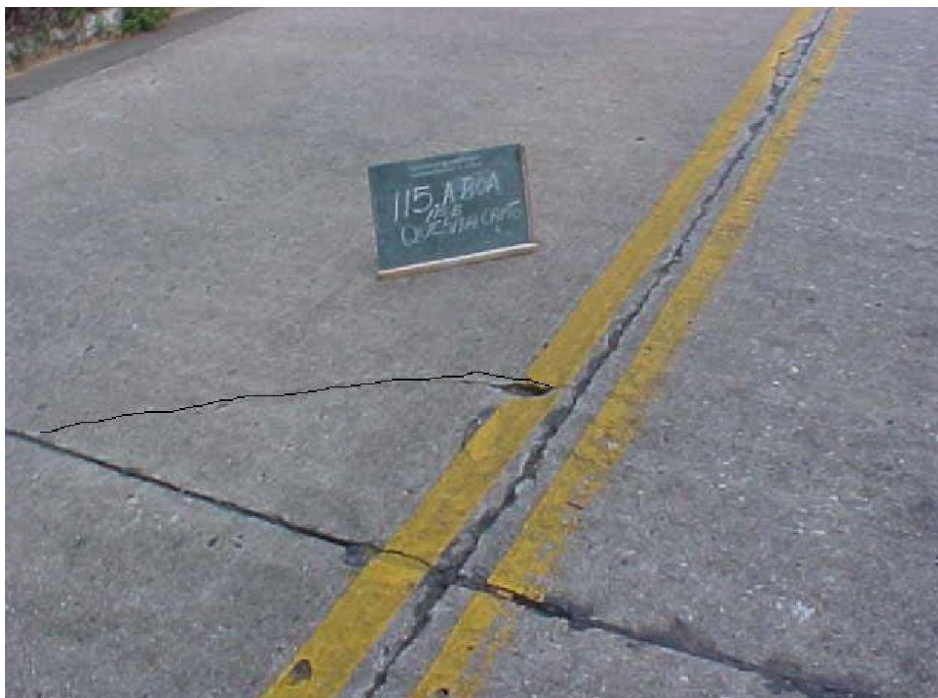
Fotografía 02: Fisuras de esquina
