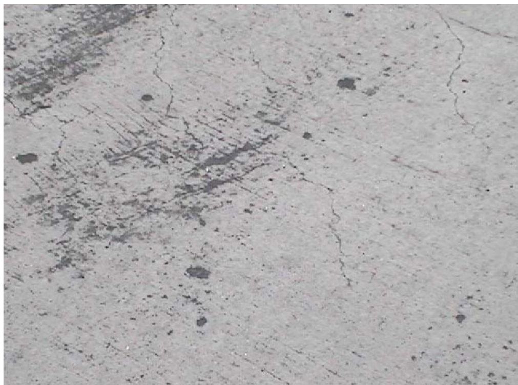
Fotografía 13: Fisura de retracción plástica
