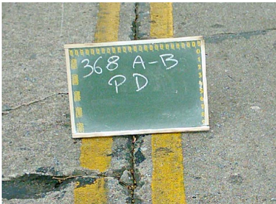
Fotografía 15: Desportillado de juntas
