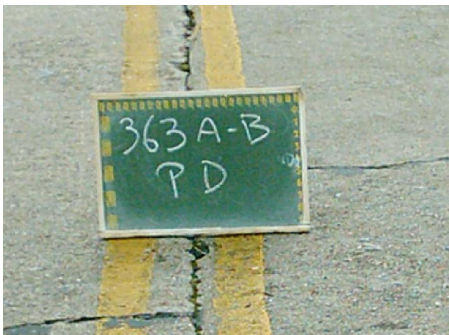
Fotografía 04: Falla en el sellado de las juntas
